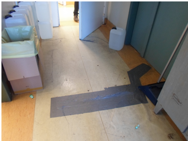
Foto 7 – pavimento esistente in PVC (in evidenza il sottofondo ammalorato)
